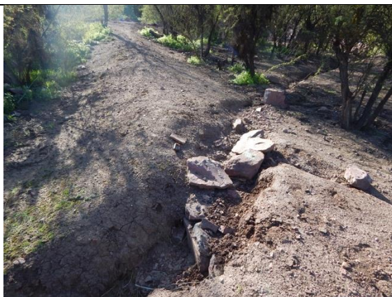
Figura N° 11. Tapial erosionado detectado hacia el suroeste del área del cementerio parroquial.
